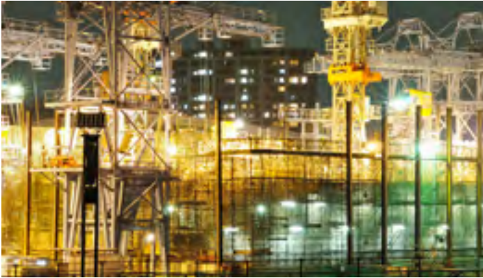
Starkes Licht auf allen Ebenen, breitstreuend oder zielgerichtet – wie es die Umgebung oder spezifische Arbeitsbereiche erfordern
